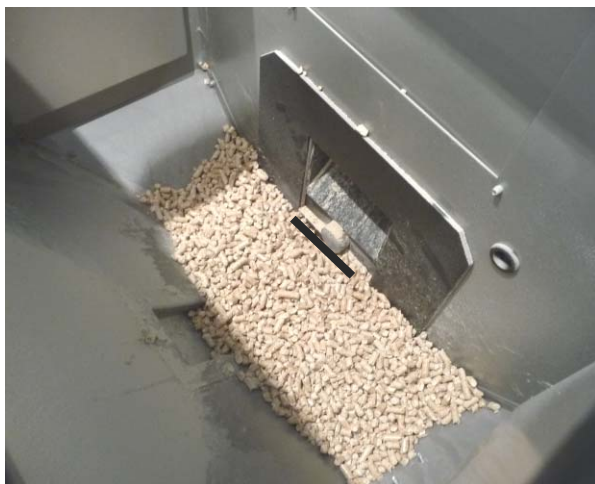
Abb. 28: Füllstand bei Inbetriebnahme
