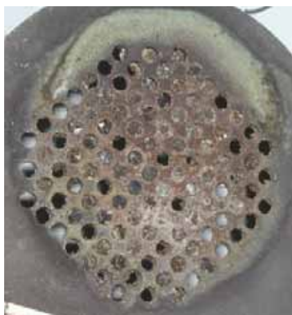
Abb. 121: Schwenkrost schlecht gereinigt,
