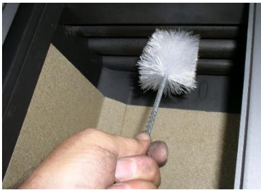
Fig. 38 : nettoyage de l'échangeur thermique
