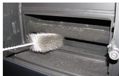
Fig. 36 : nettoyage de l'échangeur thermique
